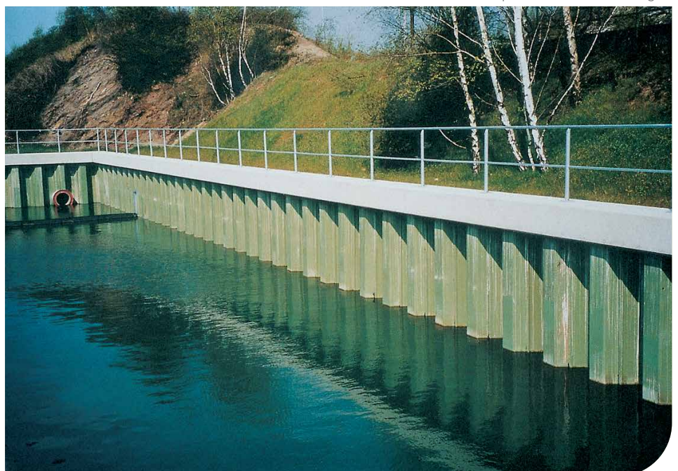
Bassin de rétention des eaux pluviales, Lübeck, Allemagne
