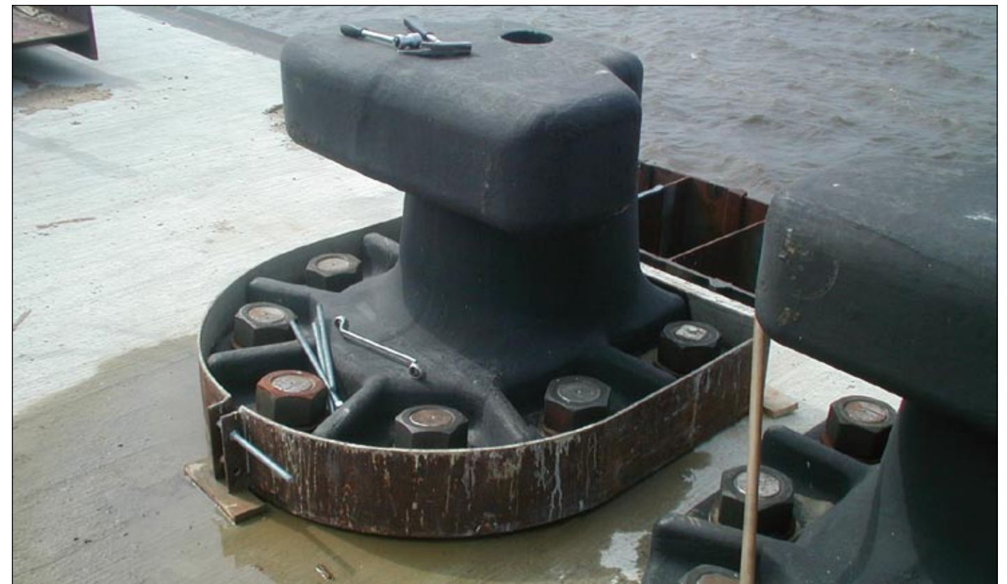
200 t Poller als Doppelpoller, montiert auf einer Unterkonstruktion in Bremerhaven. Baustelle CT IV 200-ton bollards as double bollards installed on a support structure at Bremerhaven. CT IV construction site
