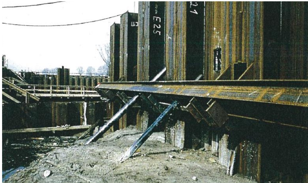
Bremer Weserschleuse, Quelle des Fotos: ARGE Bremer Weserschleuse] Einbausituation der Bohrpfähle an der linken Kammerwand mit Rundstahl Ø75 mm – Ø80 mm.
