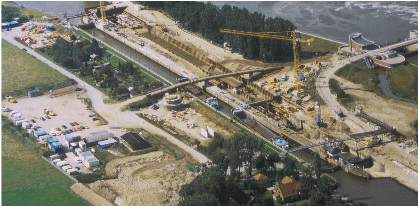
Baustelle Weserschleuse in Bremen mit ca. 130 Bohrpfählen (ca. 170 Tonnen) Quelle des Fotos: Wayss & Freytag Ingenieurbau AG
