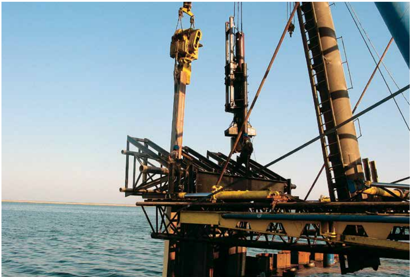
Вибропогружатель и ударный молот разместили на специально разработанной навесной платформе на рельсовом ходу.
