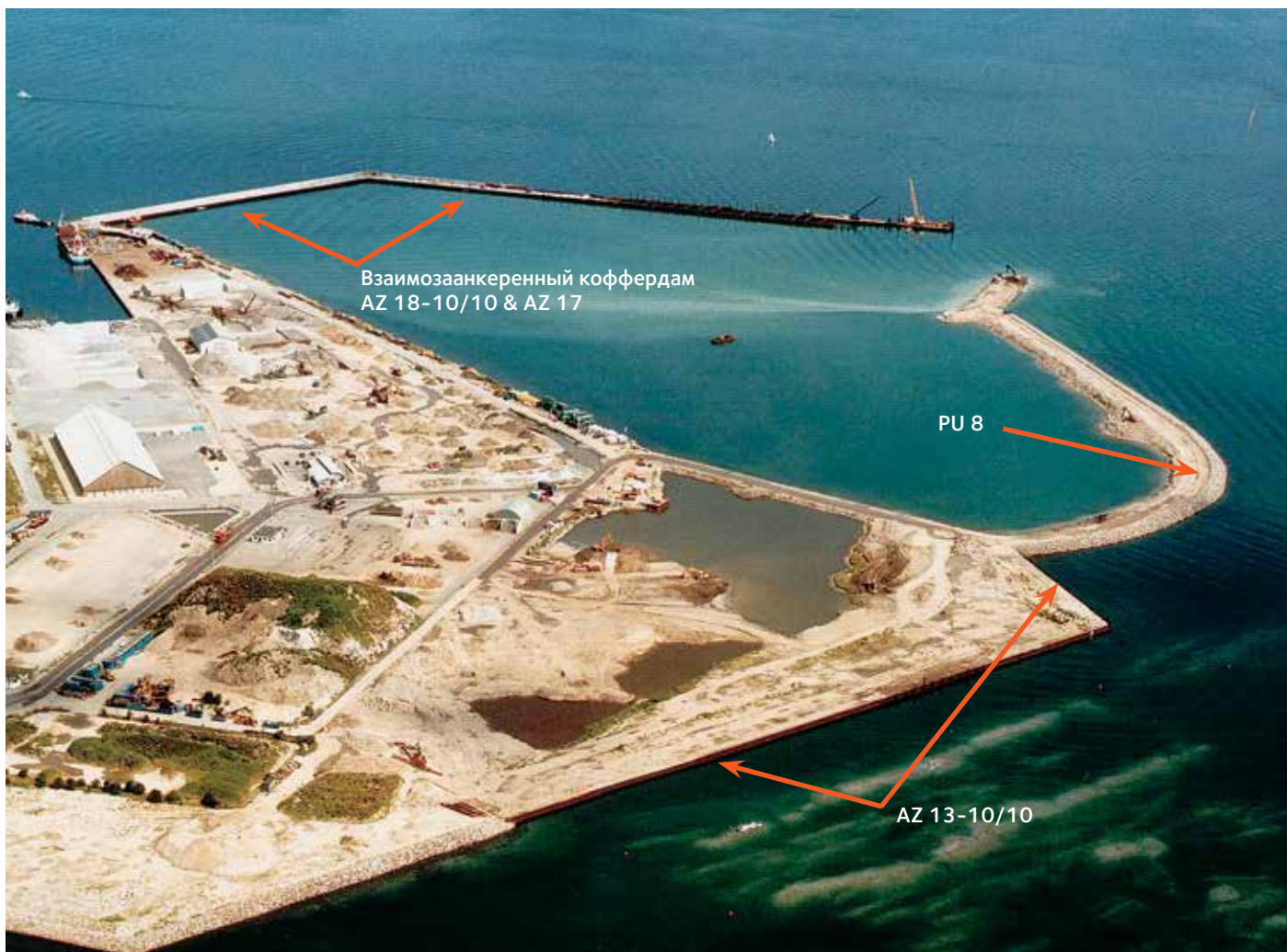
При строительстве коффердама, выполняющего одновременно роль ограждающего и причального сооружений, использовались разные типы стальных шпунтовых свай.
