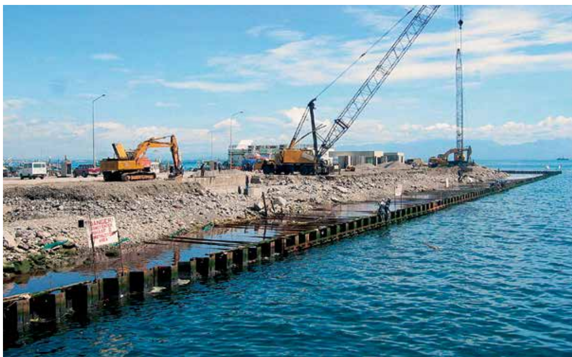
В соответствии с требованиями развивающейся рыбной промышленности построили две новых причальных стенки из шпунтовых AZ-свай.
