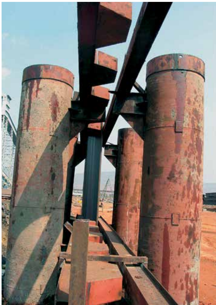
Двухуровневый кондуктор обеспечивает корректное положение шпунтовых свай в горизонтальной и вертикальной плоскостях.
