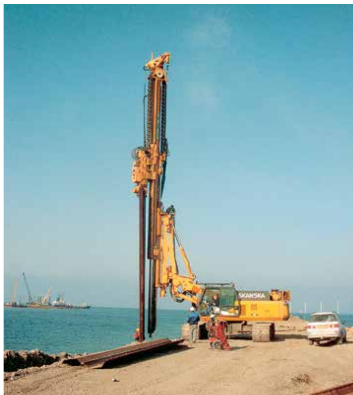
Сваи типа PU 8 на участке бермы погружали с помощью вибропогружателя, установленного на экскаваторе.
