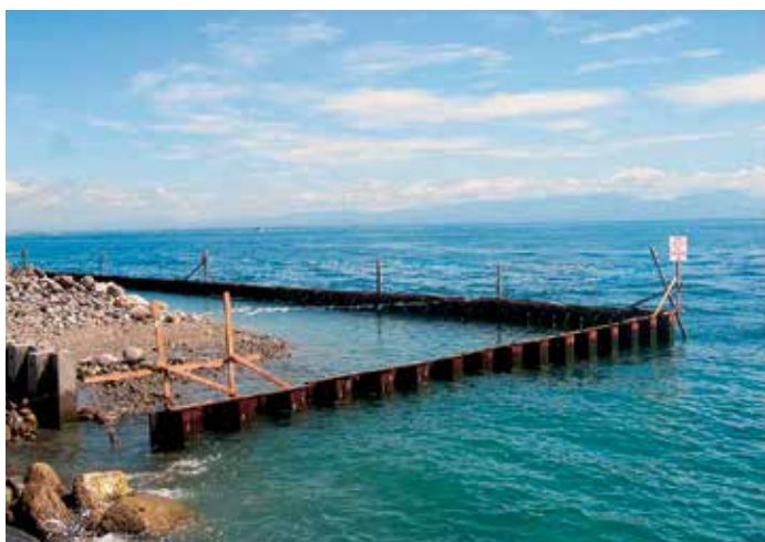
Новая стенка из стальных свай причала 2 установлена на расстоянии 27 м перед существующим железобетонной стенкой.
