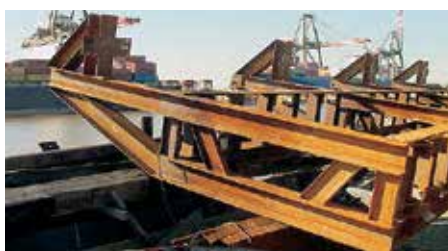
Панели из неопрена, установленные на кондукторе, обеспечивали защиту покрытия сваи при их погружении.
