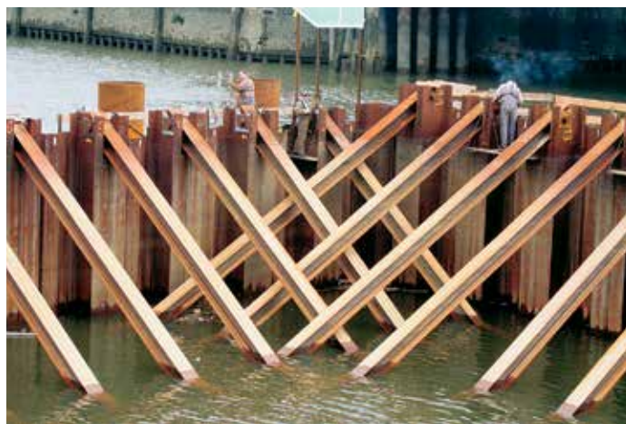
Угловые грунтовые анкера устанавливали с особой тщательностью, поскольку они пересекались на разных уровнях.
