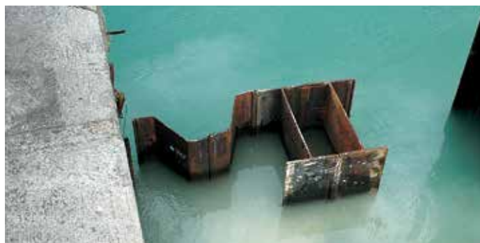
Место соединения нового и существующего причалов: к пластине, установленной на крайнем кессоне существующего причала, был приварен замковый элемент AZ-сваи для перехода на шпунтовую стенку нового причала.
